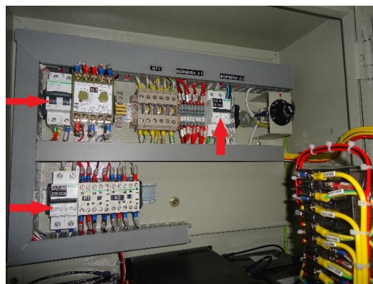
Fig.3: Painel da proteção com os disjuntores BT ligados
